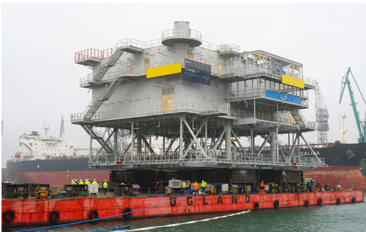
Fot. 3 Zrealizowana morska stacja elektroenergetyczna dla projektu Baltic Power
